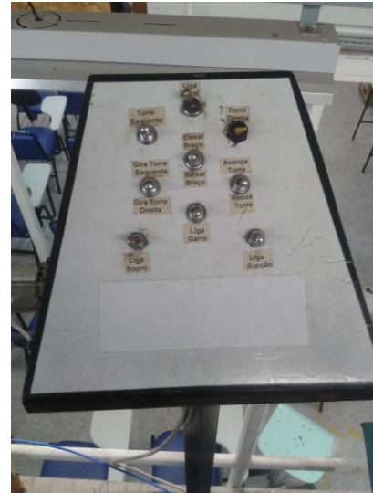
Figura 5. Central de comando
